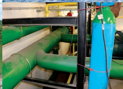
Salle des machines
